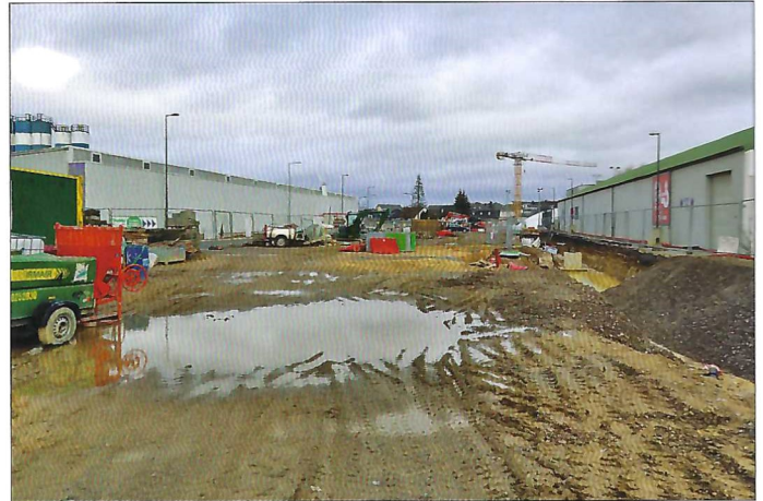
Mehr Arbeit gibt es noch in der Rue des Scillas im Bereich Howald. Hier sind inzwischen die Verlegungsarbeiten der Gleise voll im Gange.
